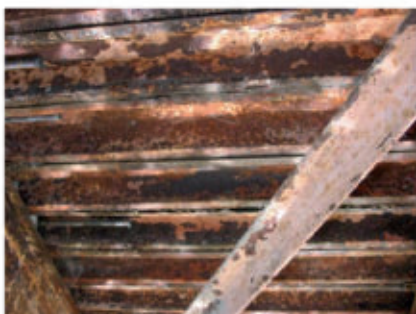
Fig. 19 - Corrosione dei coppi di sostegno dell'impalcato
