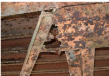
Fig. 21 - Corrosione della piastra
