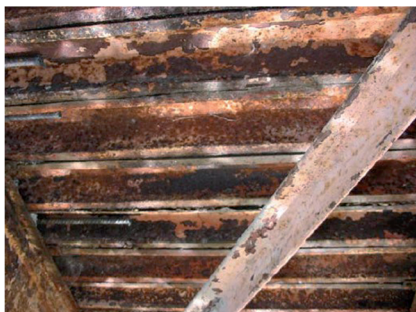
Fig. 19 - Corrosione dei coppi di sostegno dell'impalcato
