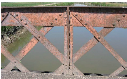
Fig. 17 - Montante con deformazioni dovute a ossido fra i profili
