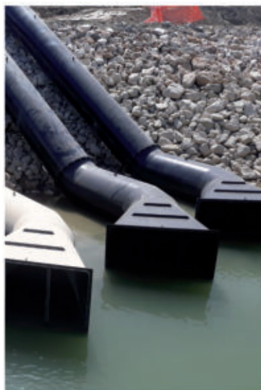
Fig. 14 - Vista frontale dei diffusori terminali
