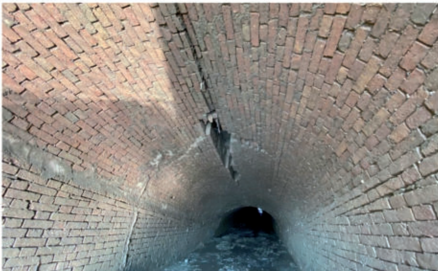
Fig. 25 - Canna 2 centrale: frattura prima dei lavori
