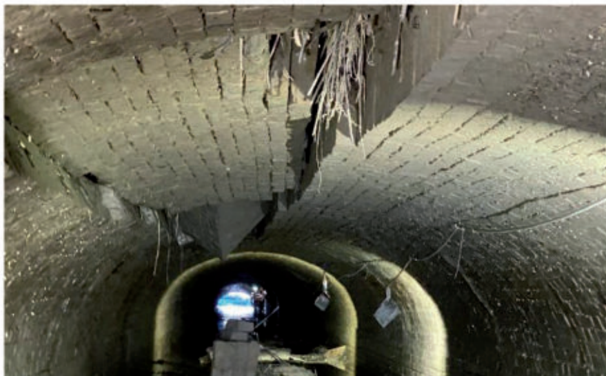
Fig. 23 - Canna 1 di monte: dissesto prima dei lavori
