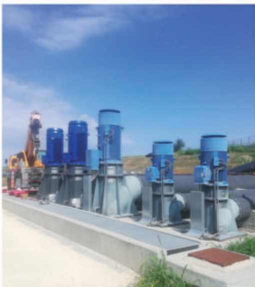
Fig. 16 - Le due nuove elettropompe installate a sinistra vanno ad aggiungersi alle tre installate precedentemente
