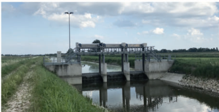
Fig. 27 - Sostegno “Muneghe” sul canale Altipiano
